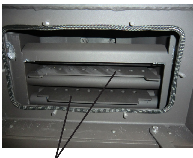
Fig. 6 Tôles de l'échangeur de chaleur
