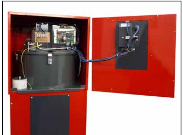
Elektroinstallation und Elektronik AC21 nach Demontage der Frontplatte
